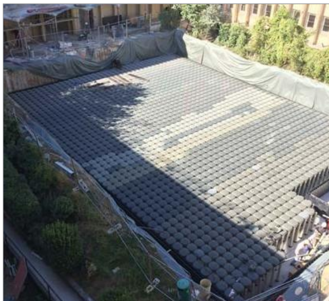
Rezervor de colectare a apei sub o zonă rezidențială
