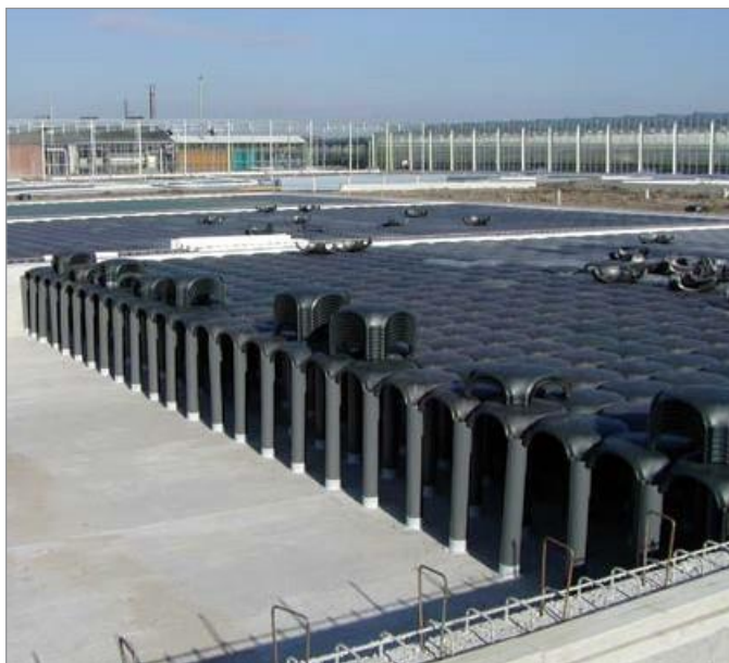
Rezervoare de colectare a apei într-o seră
