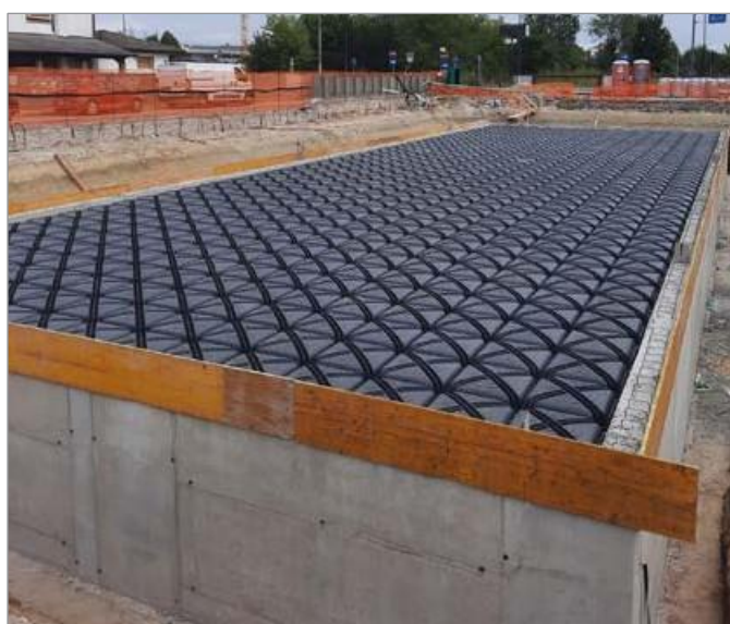
Rezervor de colectare a apei sub o zonă industrială
