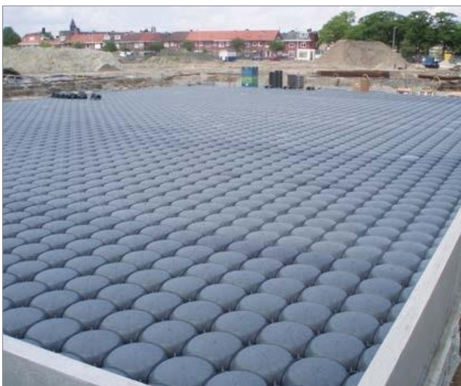
Rezervor de colectare a apei sub o zonă industrială
