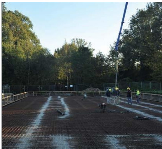
Rezervor de colectare a apei
