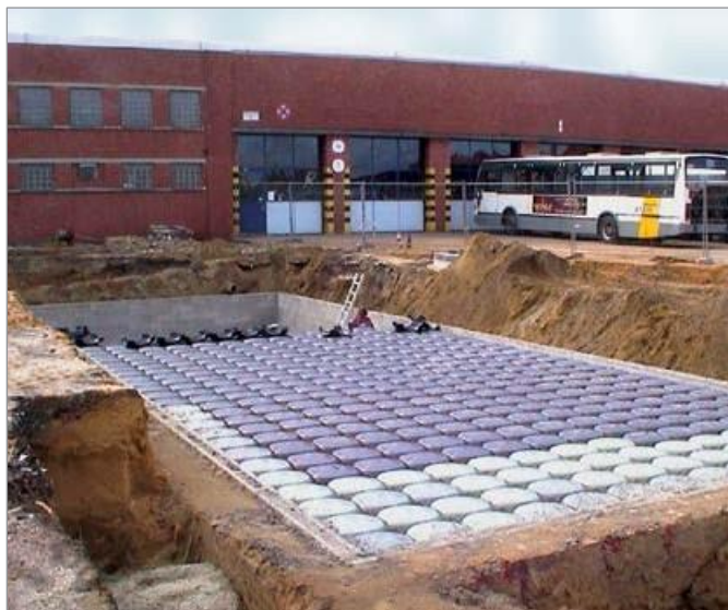
Rezervor de colectare a apei sub o parcare.
