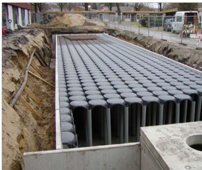
Rezervor de colectare a apei sub o zonă rezidențială
